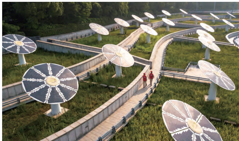
左图：2022年6月16日，江苏省镇江市扬中市滨江公园借助“光伏+储能”成为江苏首个“零碳公园”，电力工人正在巡视光伏发电站发电设施。
