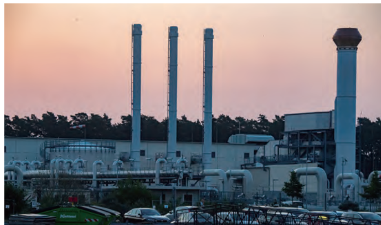
左图：2022 年 7 月 20 日，德国梅克伦堡-西波美拉尼亚邦卢布明，德国卡德天然气运输公司“北溪-1”号管道天然气接收点。
