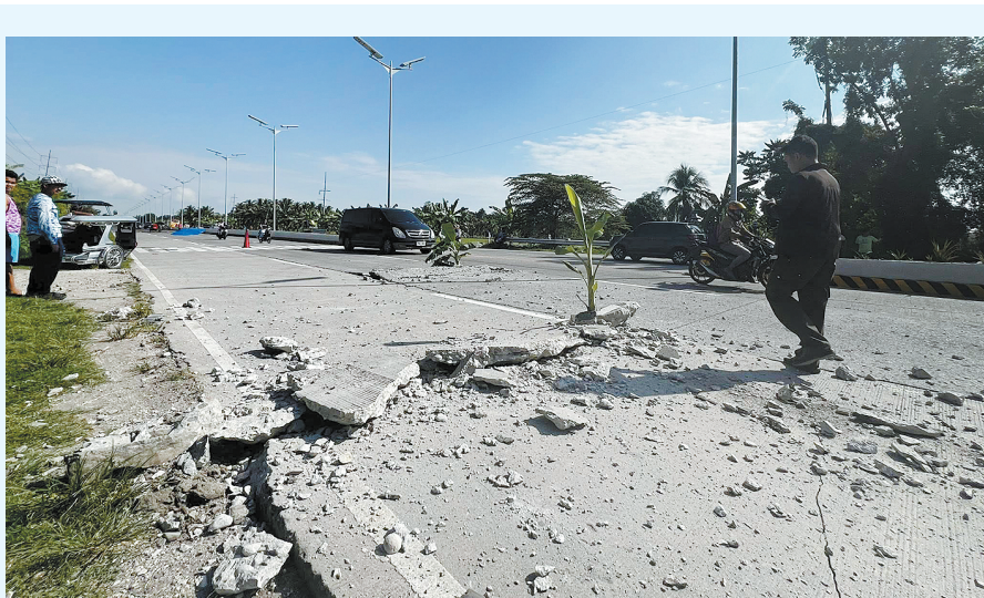
■ 菲律宾国道因地震而出现裂缝
