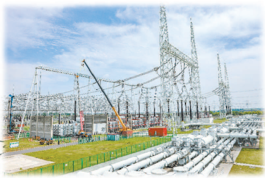
▲ 国网上海电力员工在练塘1000千伏变电站主变扩建工程现场组织开展施工区域隔离围护安装工作
