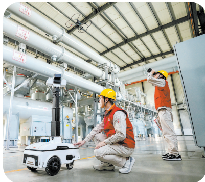
▲ 500千伏三林变电站装备了室内无人机、机器人等先进巡视装备
