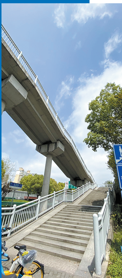
坡道坡度太陡太险，远超安全标准 本版摄影 记者 陆常青
