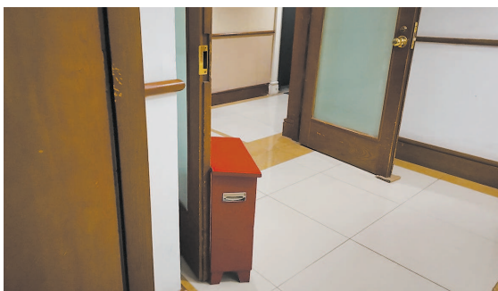
延安西路商住楼的常闭式防火门被灭火器箱顶住,大门敞开
