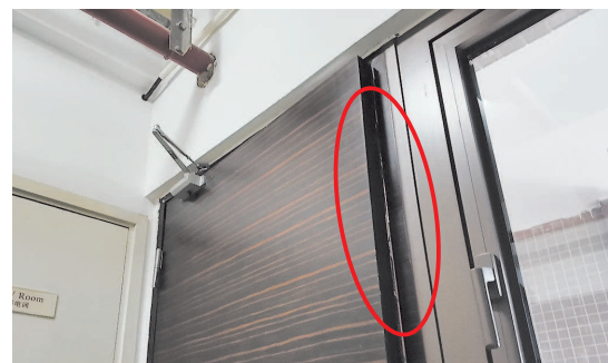
新闻路居民楼内,防火门变形,无法关闭 本版摄影 曹博文
