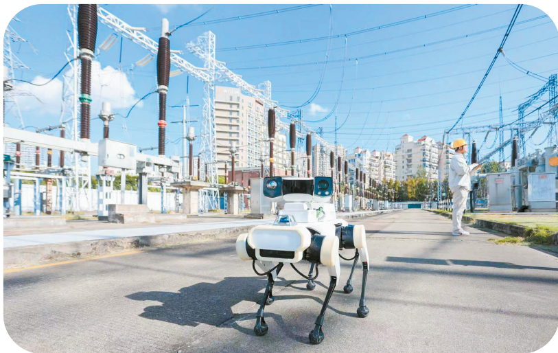
国网上海电力应用智能巡检机器狗在变电站开展户外设备巡视
