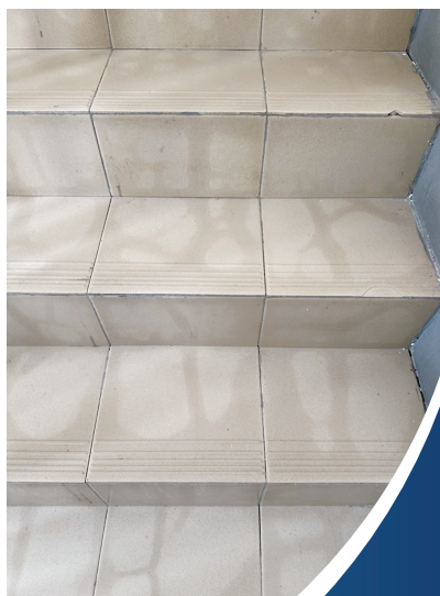
2号楼楼梯地砖上残留大量水渍 本报记者 徐驰 摄
