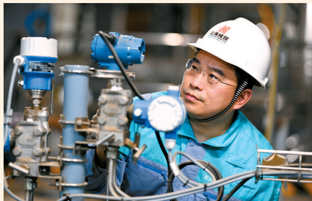
杨戍雷正在对设备进行巡检
