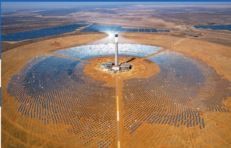
■ 中国企业在南非承建的光热电站项目
