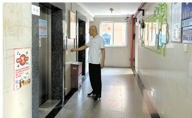
小区一号楼维修后的电梯 杨玉红摄
