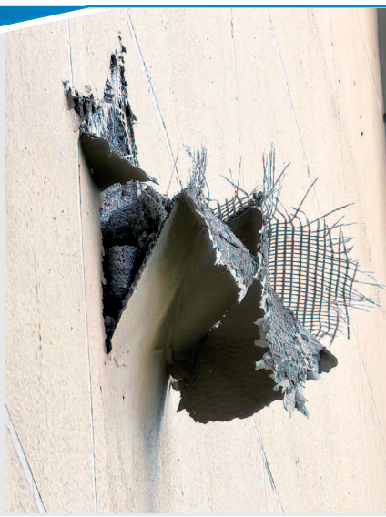
外墙脱落「翻卷」
