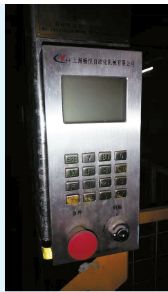
机械车库升降操作面板连电都未通
