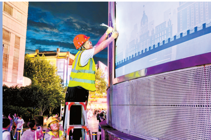
■ 昨天傍晚，九江路山西中路口的户外围挡被大风刮起，南京路步行街管理扎加固，消除安全隐患。杨建正 摄
