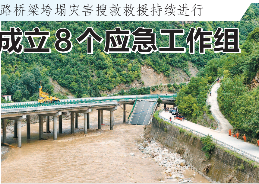
丹宁高速水阳段山阳方向K46+200处平坪村二号桥垮塌现场(无人机照片) 新华社发
