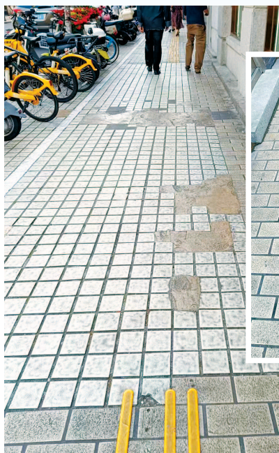
▲ 盲道现已修好 ▲ 盲道之前缺失了一段 徐驰 摄
