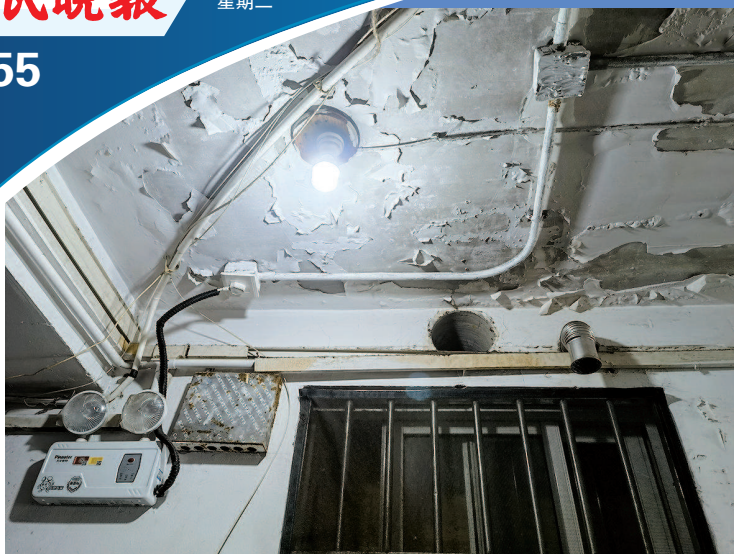
▲ 排气管通到楼道,天花板一塌糊涂
