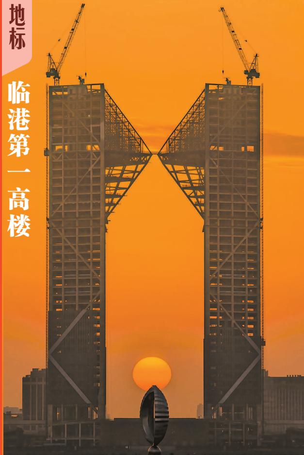
临港第一高楼——中银金融中心大厦外立面施工顺利推进过半。今年第四季度，这一地标建筑将正式亮相。 杨帆 摄影报道
