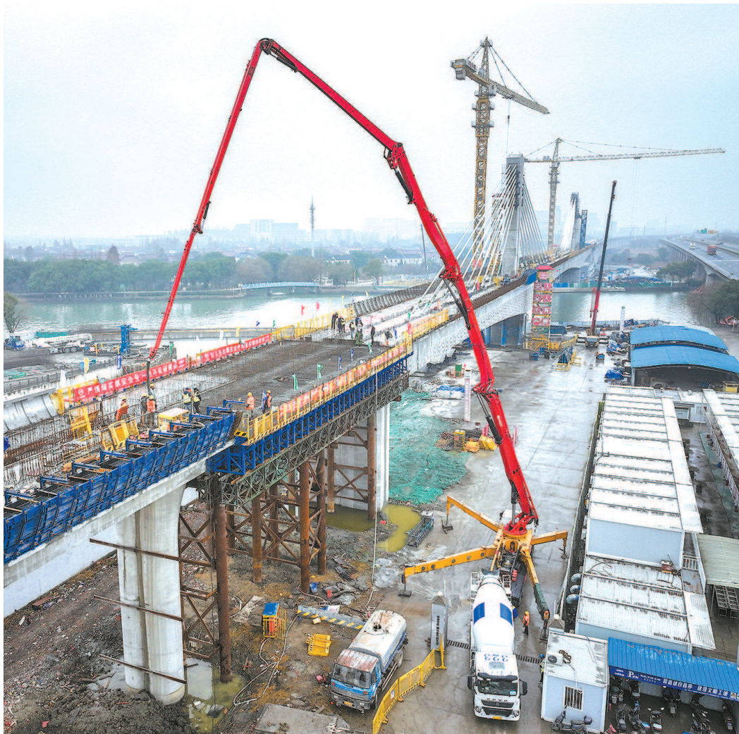
■今天上午,青浦金泽镇轨交17号线西延伸主体结构全线贯通
