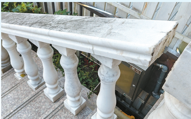
■ 楼梯扶手与立柱间脱开
