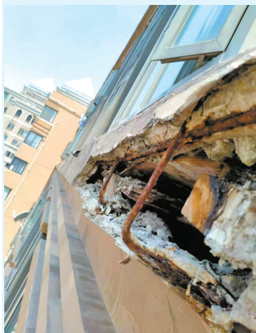
▲ 楼房外墙脱落，部分位置已露出钢筋
