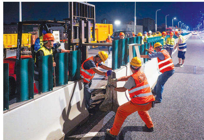
■ 昨晚11时，内环高架黄兴路上匝道关闭，施工人员开始平移道路中间护栏和铺设围挡，为之后的工程做准备 本报记者 陈梦泽 摄
