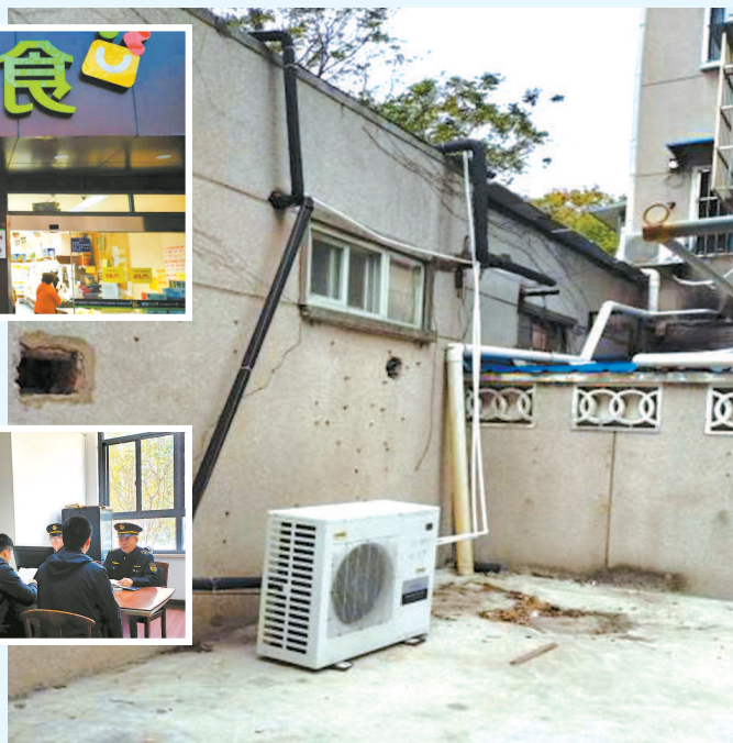
■ 清美超市冷凝机外机被安放在小区里
