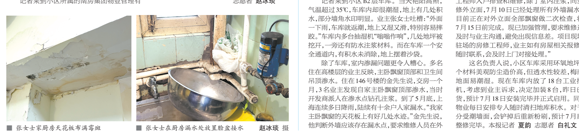
张女士厨房天花板布满霉斑 张女士在厨房漏水处放置脸盆接水 赵冰琰 摄
