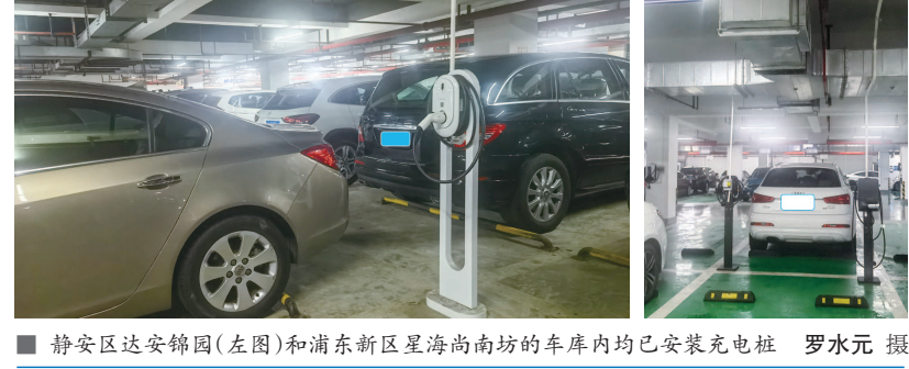
■ 静安区达安锦园(左图)和浦东新区星海尚南坊的车库内均已安装充电桩 罗水元 摄
