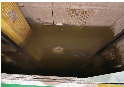
本报记者 陈浩 摄 82号电梯井变成水井
