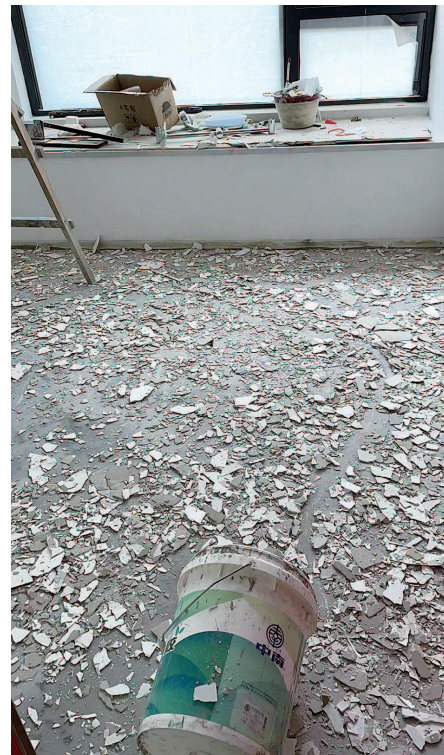
122号502室天花板泥幔掉落
