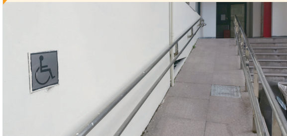
坡道太陡,坡度近30度
