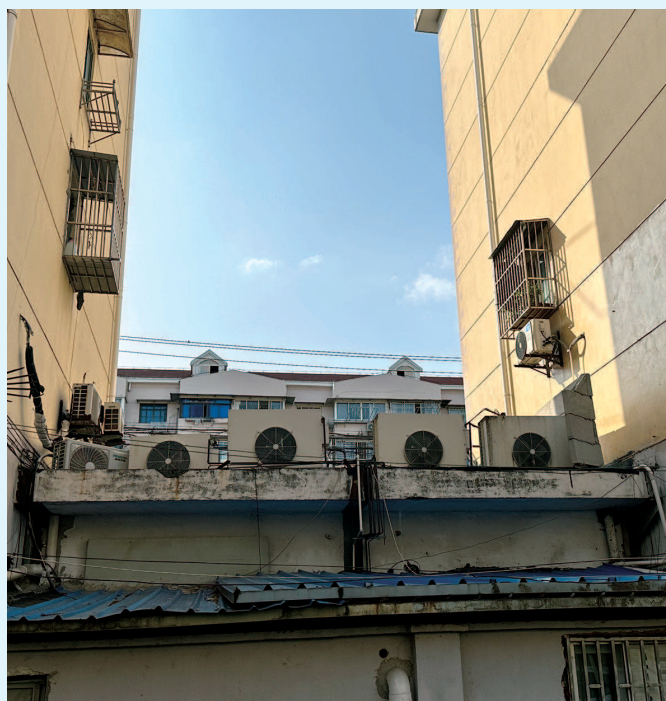
■ 4台冷凝风机转个不停
