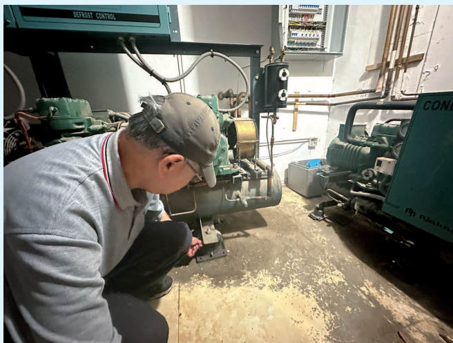
■ 压缩机下安装空气减震器后，震感有所减弱
