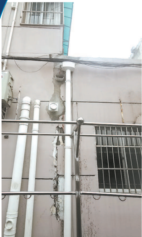
居民楼外墙上的裂缝触目惊心
