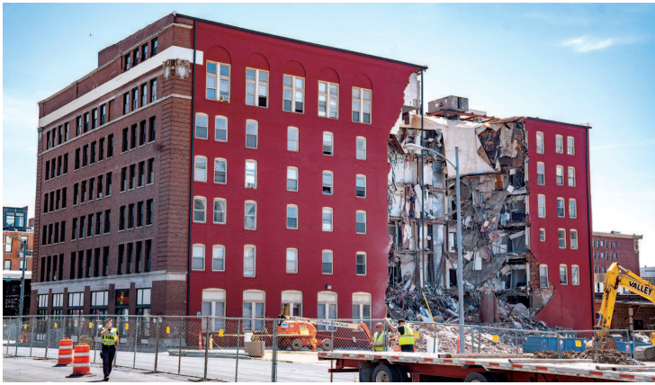
■ 公寓楼坍塌现场
