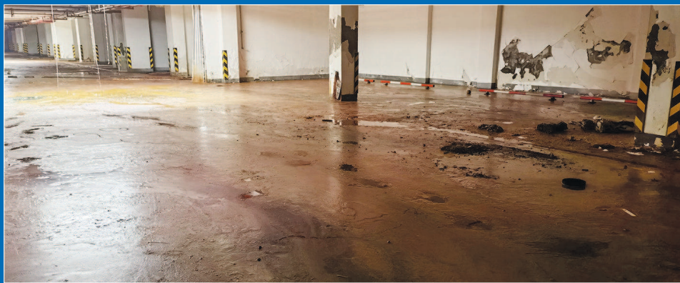
■ 竹柏路366弄内,地下车库积水里混和着一层厚厚的浮泥
