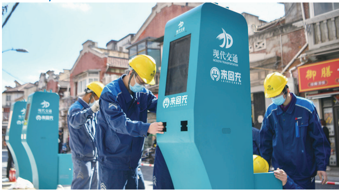
牛庄路近云南北路,工作人员安装非机动车专用充电桩,为周围居民充电提供方便 本报记者 陈梦泽 摄
