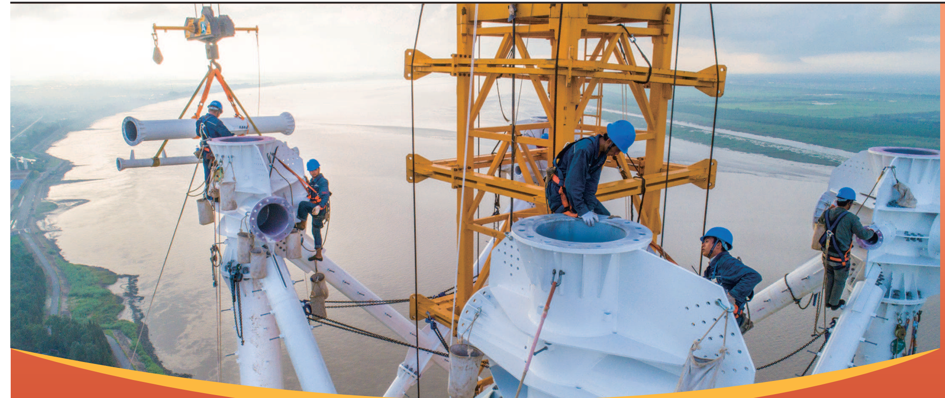
国网上海电力完成崇明500千伏输电变电工程(线路)长江大跨越北岸K2跨越塔组立工作
