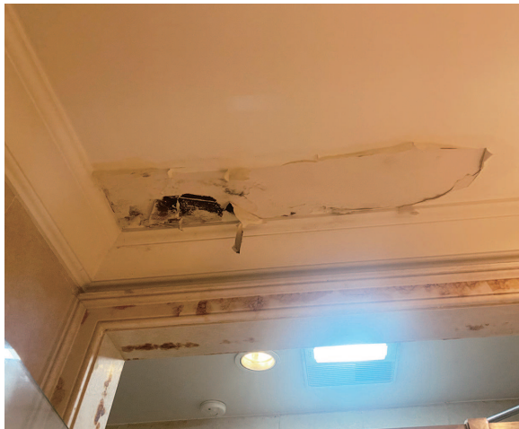
▲ 天花板受损严重 ▶ 报修记录
