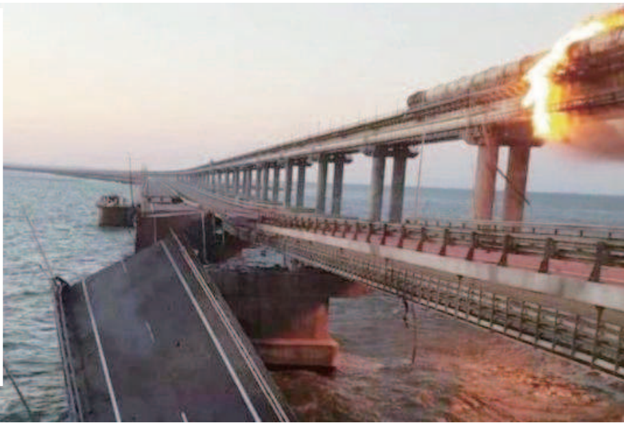
■ 克里米亚大桥爆炸后断裂
