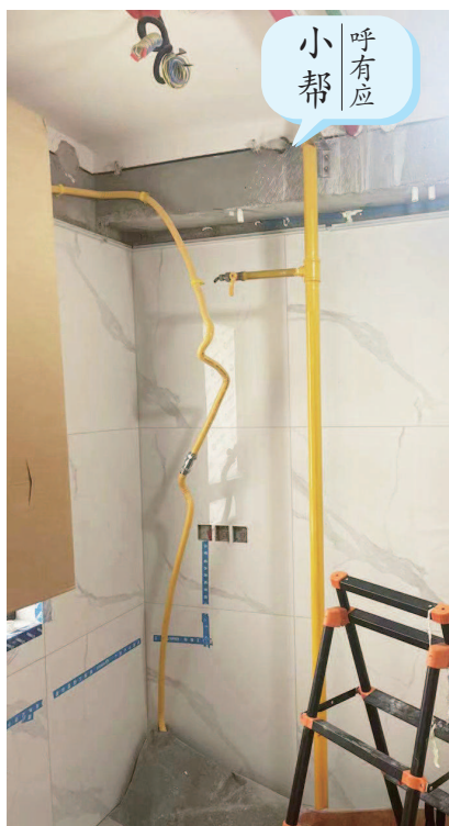
■ 业主已配合整改，将燃气管道复位 本版图片均由采访对象提供
