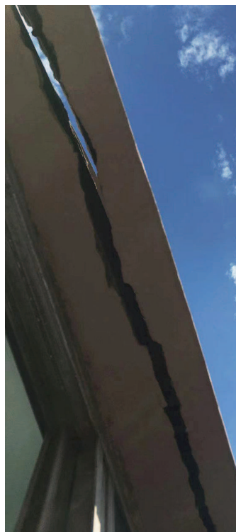
■ 11号楼外立面的裂缝 徐驰 摄
