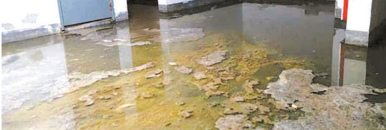
■ 地下室严重积水
