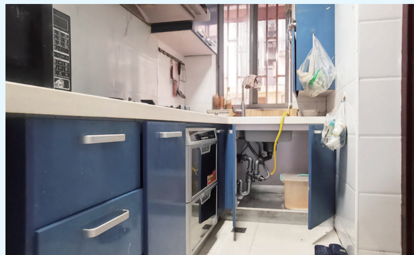
水管从厨房水槽下接出
