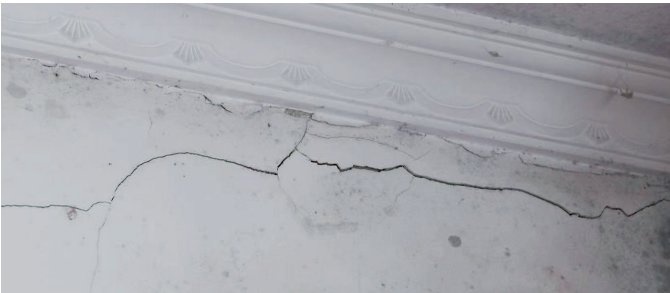
老房子墙壁开裂
