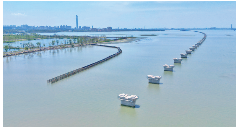
白色桥墩露出水面，高铁“水上漂”的沪苏湖铁路推进建设 本报记者 张龙 摄
