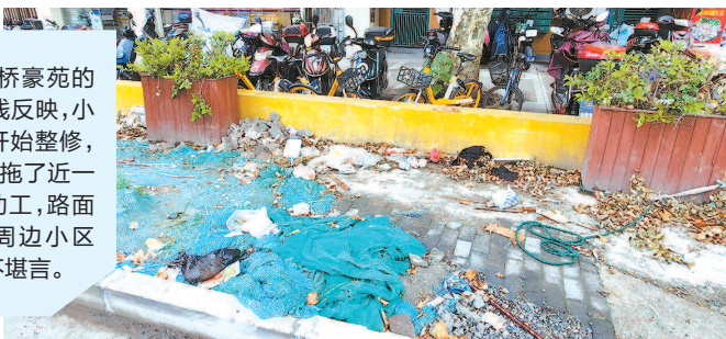
施工路面一派“惨状”
