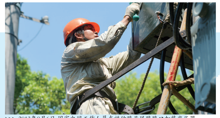
>>> 2013年8月6日,国家电网工作人员在福佑路丹凤路路口加装变压器 本报记者 陈梦泽 摄
