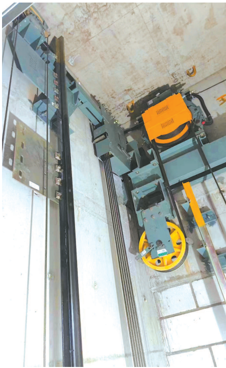
■ 电梯主机安装在紧贴居民家的墙壁上
