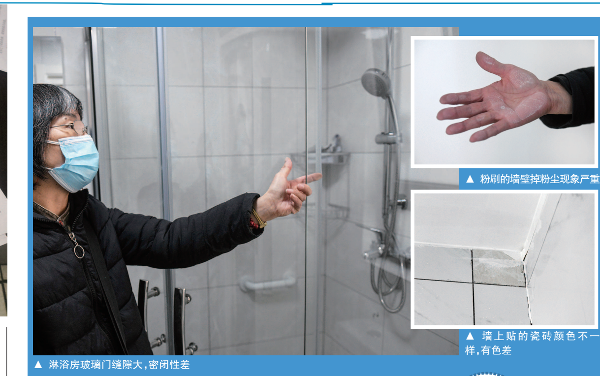
▲ 淋浴房玻璃门缝隙大,密闭性差 ▲ 粉刷的墙壁掉粉尘现象严重 ▲ 墙上贴的瓷砖颜色不一样,有色差
