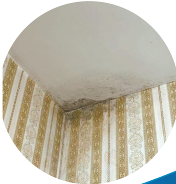
天花板和内墙上布满霉斑 投诉人供图
