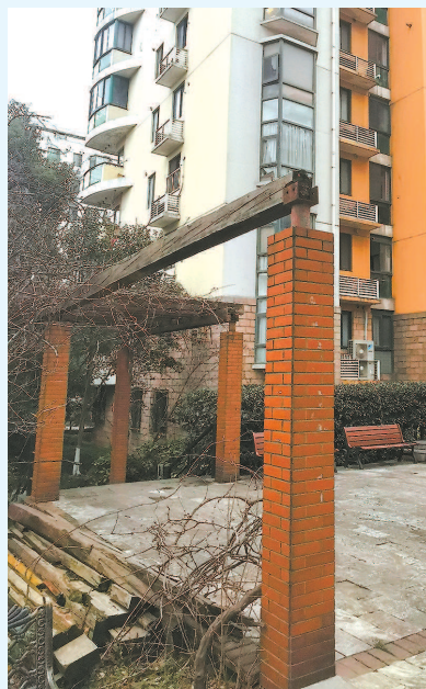
连廊上的景观防腐木都已腐烂
