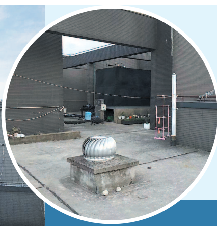
公共烟道原本应当贴地安装
