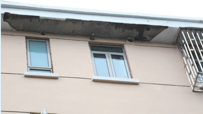
■ 楼顶屋檐外墙的石灰块脱落
