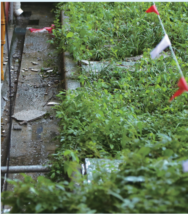
■ 外墙碎片掉落地面,周围拉起警戒线
