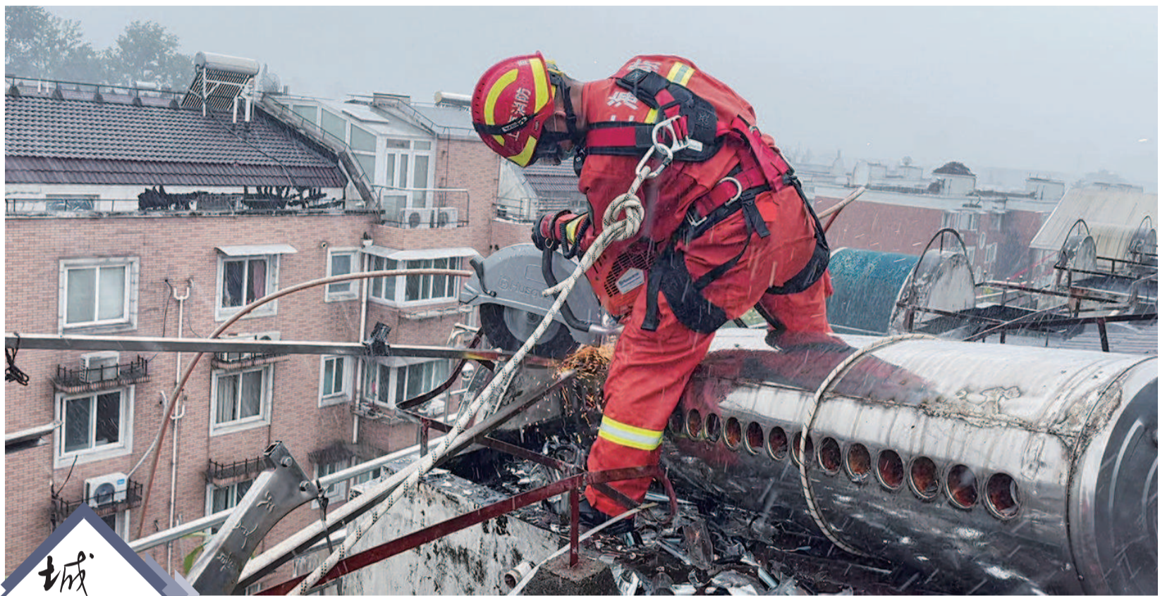
■ 昨天七时二十分,东泉路一八八弄一幢楼顶的太阳能热水器被吹倒,存在高坠危险,南站消防救援站队员用无齿锯将热水器切割转移,并将剩下材料固定 通讯员 唐郁 记者 张龙 摄
