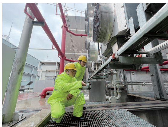
■ 昨天,国网上海检修公司华新换流站运维人员巡检户外主设备,确保三峡水电入沪枢纽安全 记者 孙中钦 通讯员 朱鹰杰 摄
