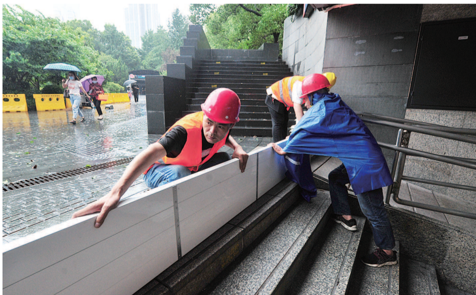
■ 为防止雨水倒灌,工作人员昨天在南京西路新世界下沉式广场通道口围起临时挡板 杨建正 摄
